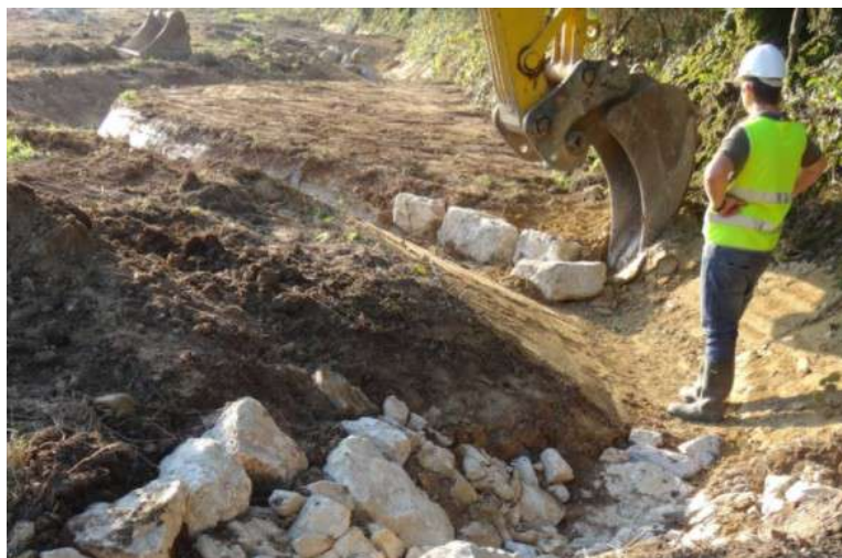
Illustration 23: Reméandrage : tracé du cours d'eau et stabilisation du fond et des berges
