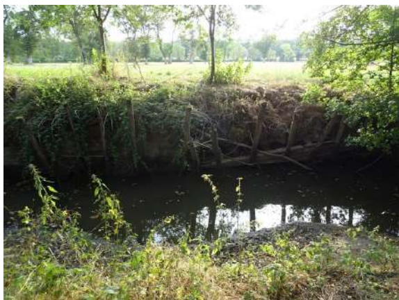
Illustration 43: Piquets en bois et pylônes en béton (Gourdon, GOU588)
